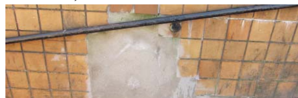
Klinker beskidte med grimme reparationer
