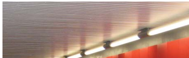
Belysning i tunnel, linjearmaturer
